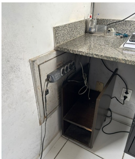
Figura 9 - Filtro de linha com emendas e em contato com estrutura metálica
