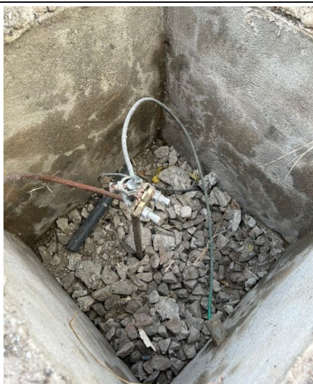
Figura 13 - Caixa de inspeção
