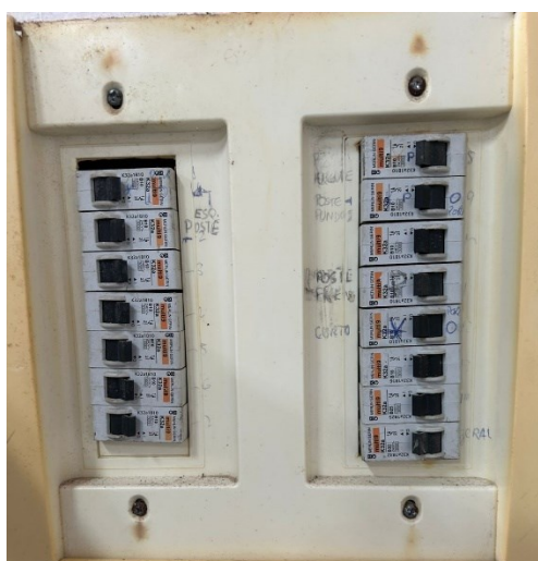
Figura 3 - Falta de identificação dos circuitos
