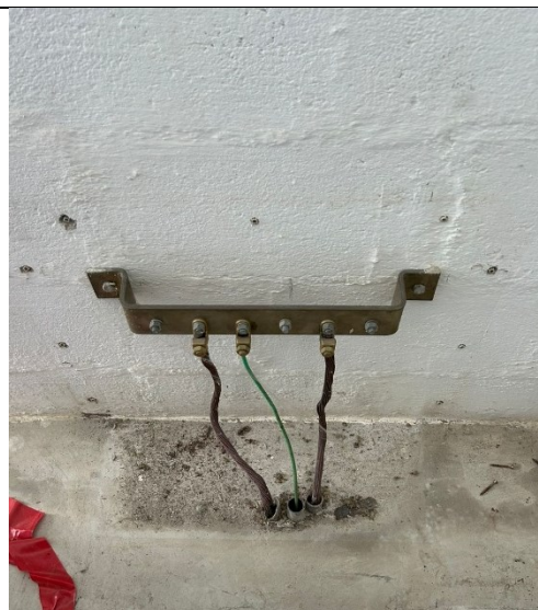
Figura 14 - Barra de equipotencialização
