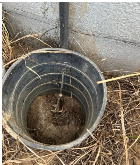
Figura 12 - Poço de inspeção do SPDA
