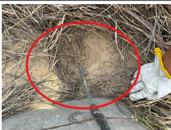
Figura 5 - Falta poço de inspeção do SPDA
