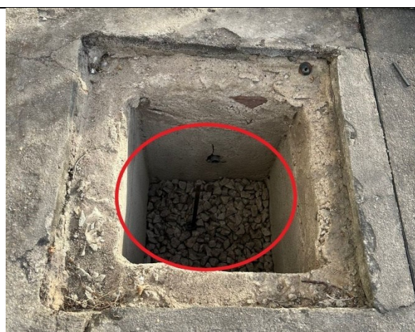
Figura 6 - Falta interligação de aterramento
